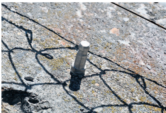
Hightech. Im Mauerwerk eingebaute Messpunkte geben der Bauherrschaft jederzeit Auskunft über mögliche Verschiebungen.
