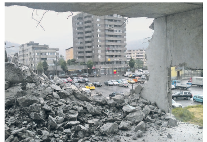
Vorsicht. Während dem eigentlichen Abreissen wird die Strasse aus Sicherheitsgründen zeitweise für den Verkehr gesperrt.
