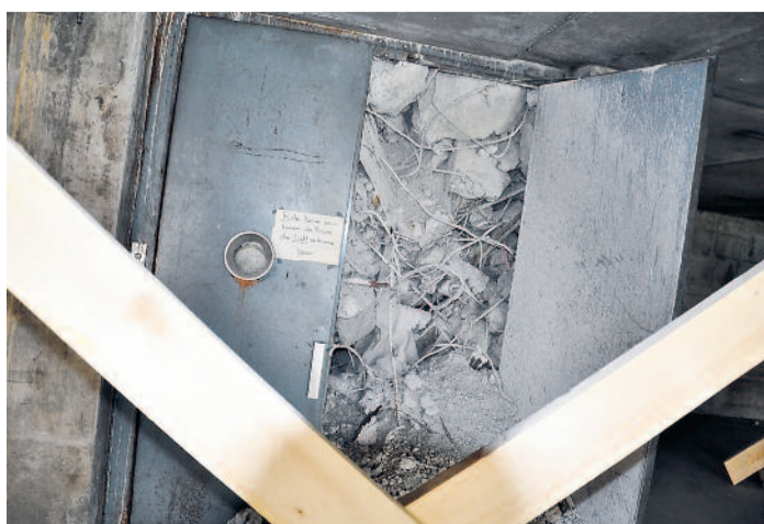
Ausgedient. Dieser Aufzug befördert definitiv keine Fahrgäste mehr.
