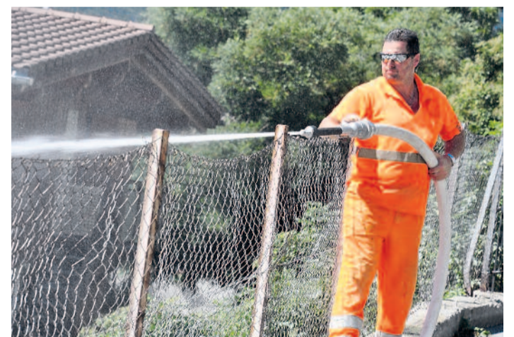
Wasser, marsch! Mit einem Hochdruckschlauch sorgen die Bauarbeiter dafür, dass nicht zu viel Staub aufgewirbelt wird.
