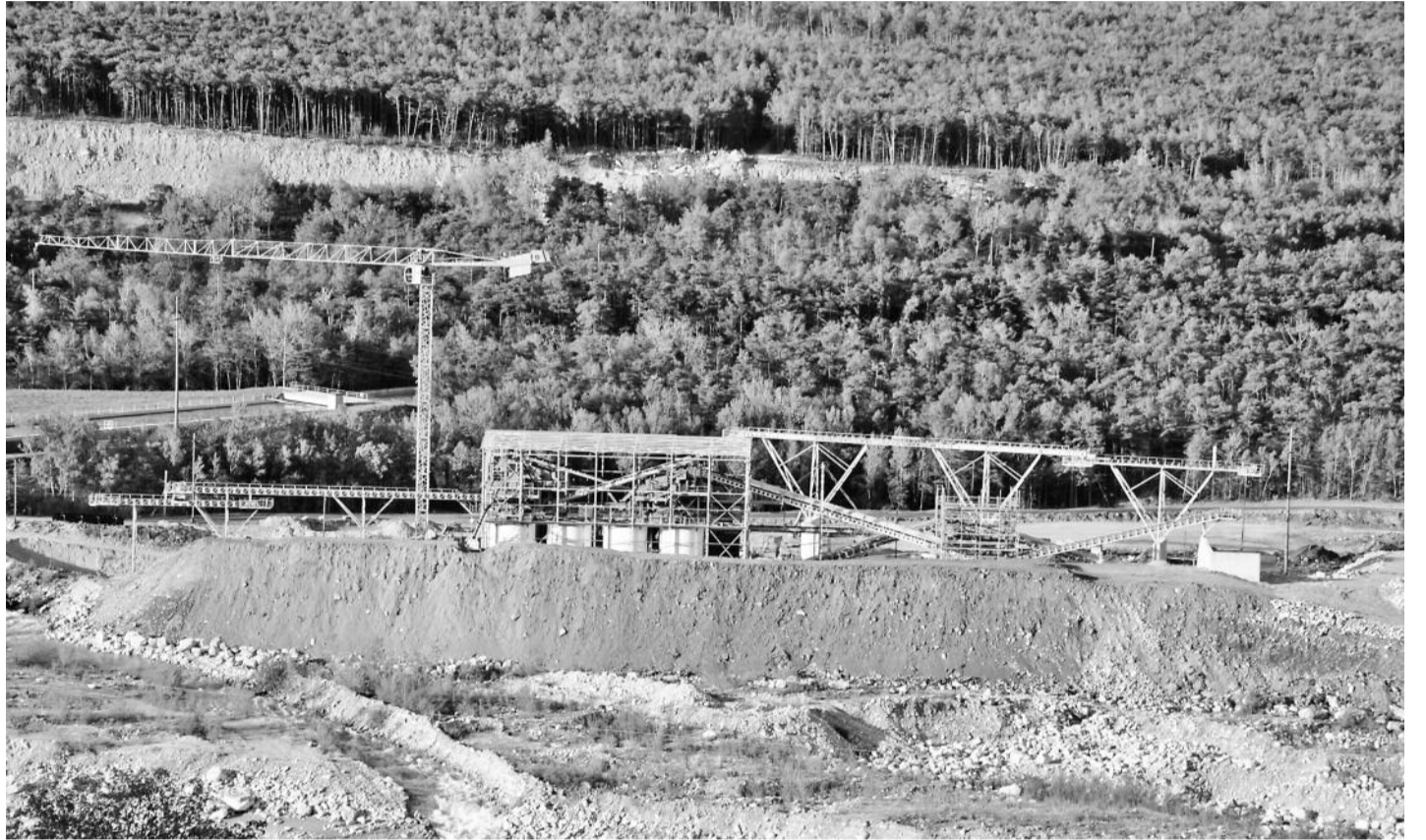
Der Neubau. Er weist höhere Kapazitäten auf als die bestehenden Anlagen. Bis zur Fertigstellung werden vor allem noch die Fassade hochgezogen, das Innenleben der Anlage ergänzt und die Förderbänder montiert. FOTO WB
